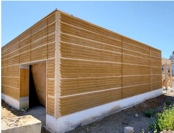
Murs porteurs en zone sismique II : pisé en terre crue sans aucun adjuvant / angles et lits de chaux
