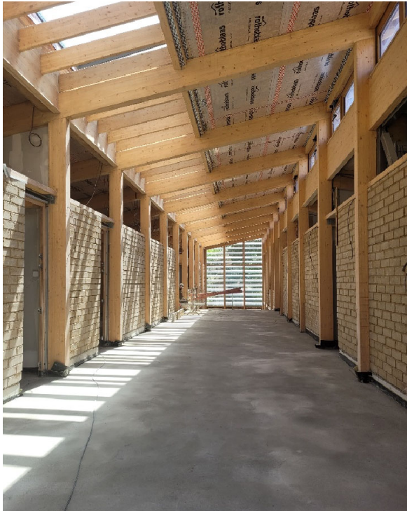
Vue de la circulation intérieure en chantier, avec les parois en briques de terre crue entre charpente bois
