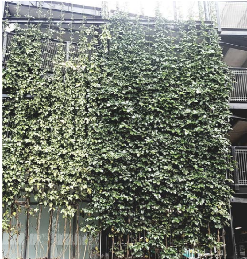
Câbles inox verticale
