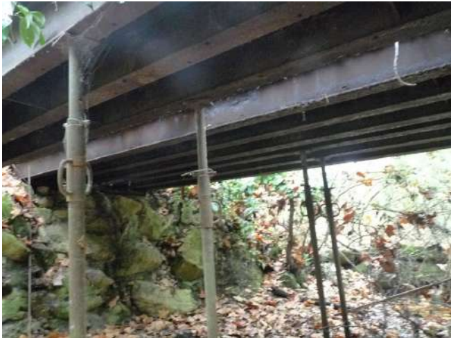
Photographie de l'Etat des Lieux depuis le bas
