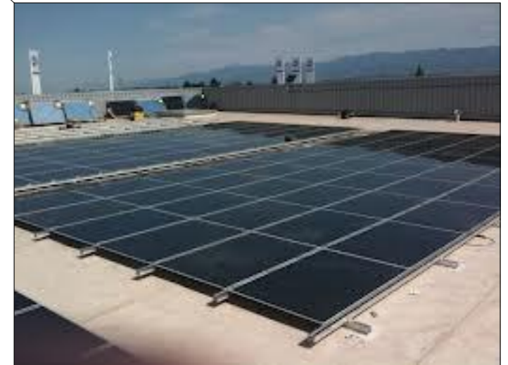
PANNEAUX PHOTOVOLTAÏQUES AUTO-CONSOMMATION
